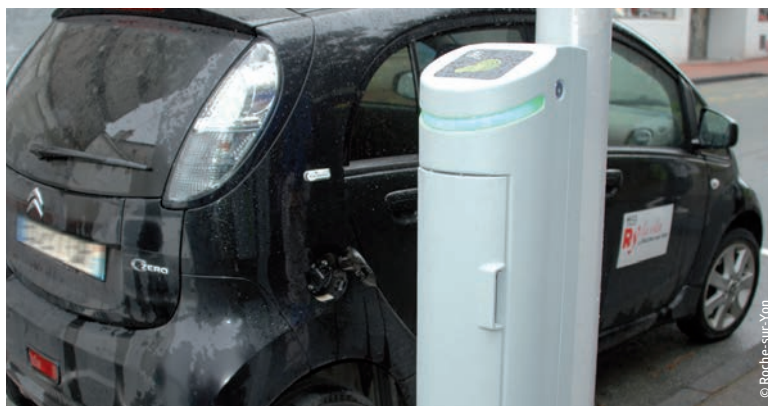
Le dispositif mis en œuvre par l'agglomération de La Roche-sur-Yon permet aux automobilistes de recharger leur véhicule électrique directement sur le dispositif d'éclairage public.
